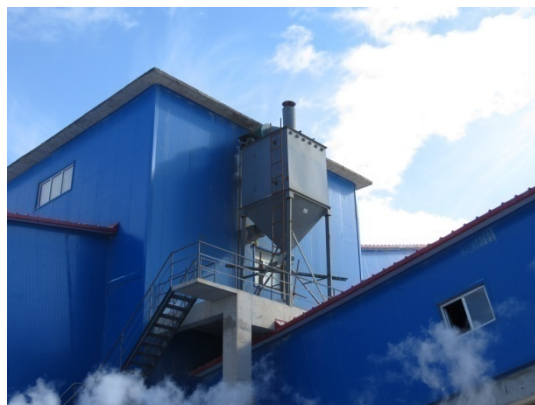
多宝山铜业选矿车间除尘器
