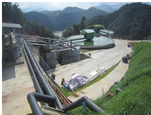
紫金山金铜矿哑坑 3 万吨/天废水处理系统
