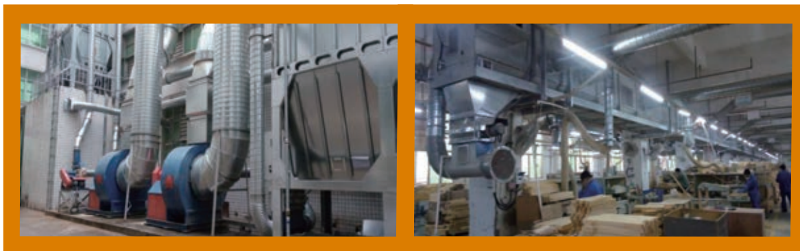
木工車間粉塵處理裝置
