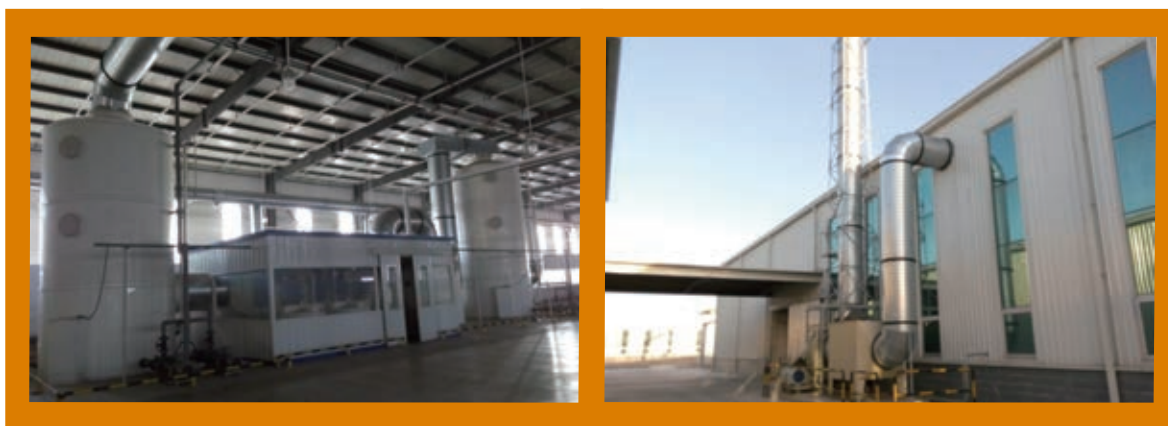
海綿發泡廢氣處理裝置1
