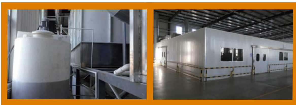
板式傢具廠廢水處理裝置
