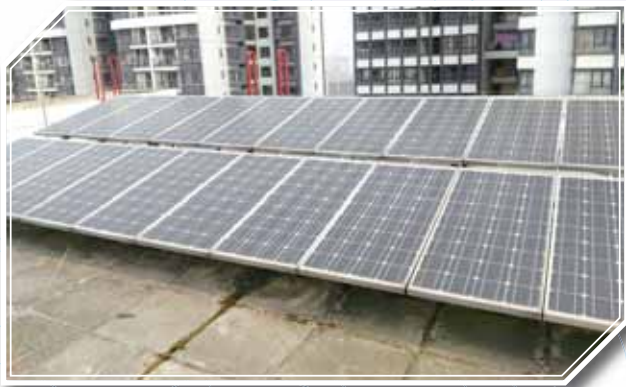
Solar panels 太陽能板
