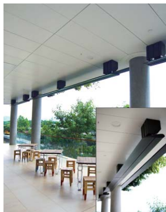
「The Green Atrium」內的「誘導式通風裝置」
