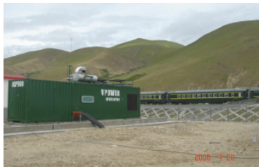
鐵路信號站發電系統
