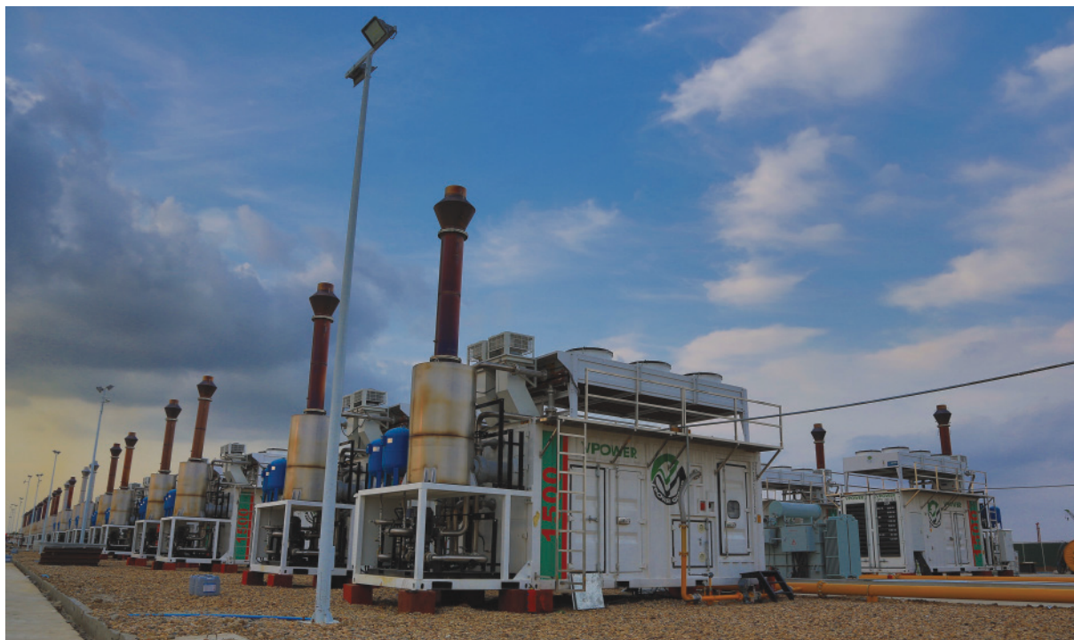
高速發動機式燃氣分佈式發電站
