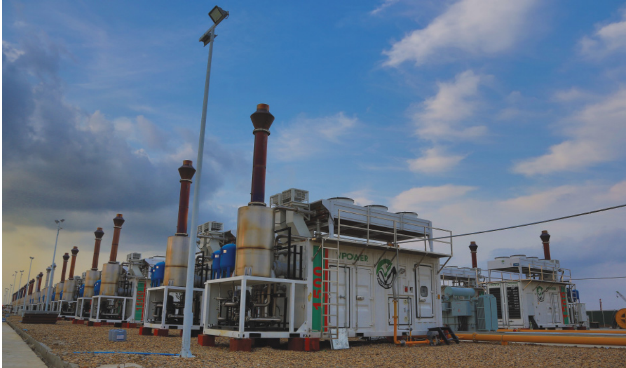
高速發動機式燃氣分佈式發電站
