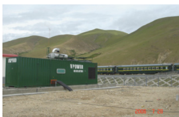
鐵路信號站發電系統
