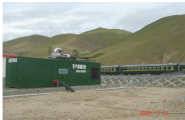
鐵路信號站發電系統
