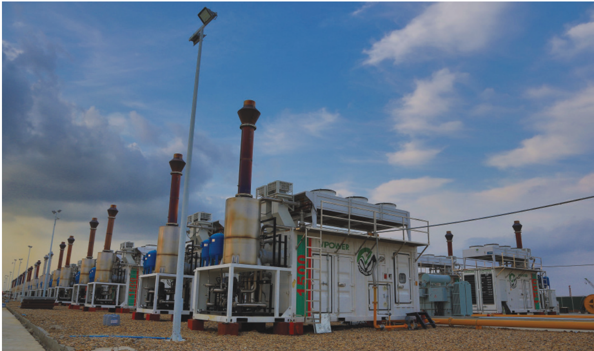
高速發動機式燃氣分佈式發電站
