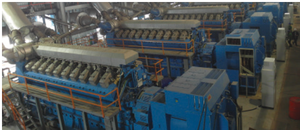
Teluk Lembu II — 使用中速燃氣發動機的發電系統
