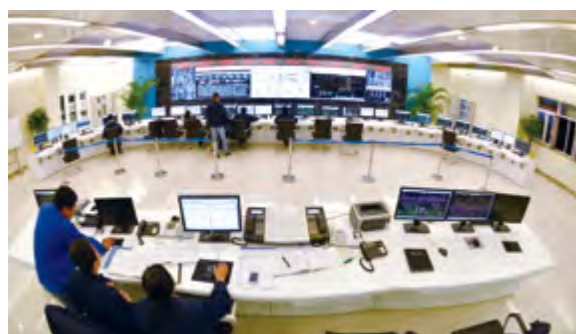
北京高井热电厂在全国第一个实施在役机组脱硝改造。
