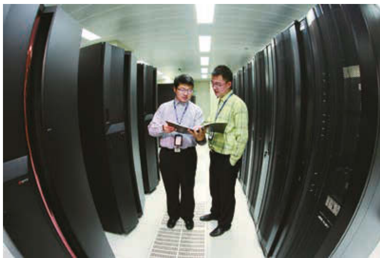
交行数据中心机房
