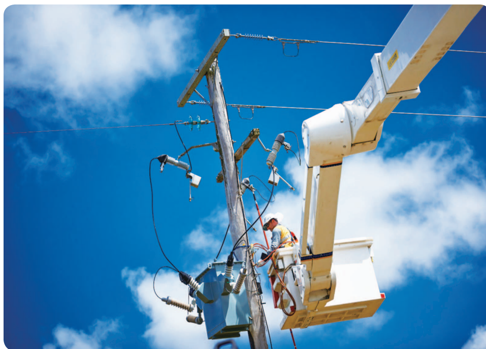
Powercor 在維多利亞省西北部米爾杜拉附近架設新的高壓電纜。
