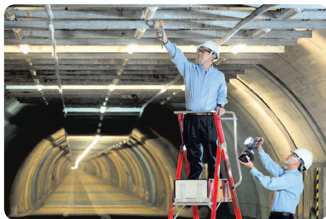
使用電纜隧道可減低極端天氣對港燈供電網絡所造成的影響。
