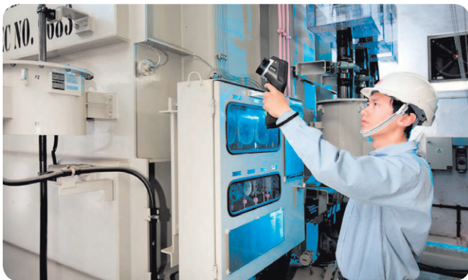
我們密切監察網絡組件，盡力預防故障發生。
