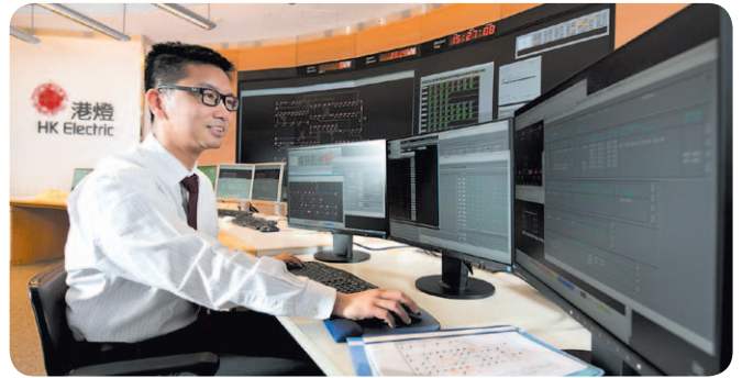
港燈系統控制中心配備先進電腦系統，確保供電可靠性。
