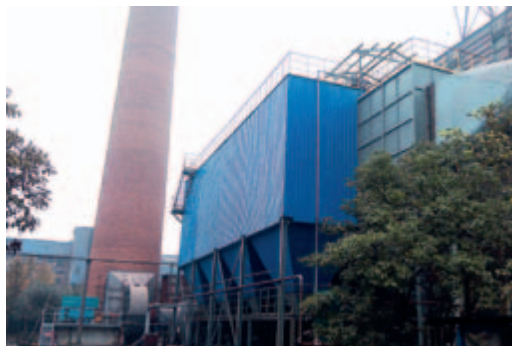
1#燒結機尾除塵提效改造
