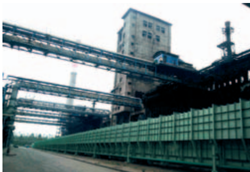
建成機側爐頭煙地面除塵站
