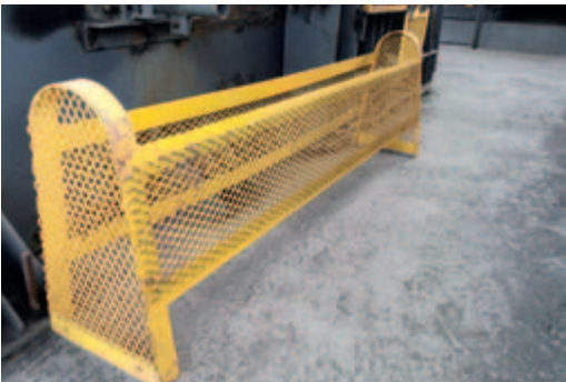
機械防護罩整改
