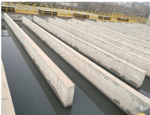
中州鋁業一體化淨水廠往返式絮凝池
