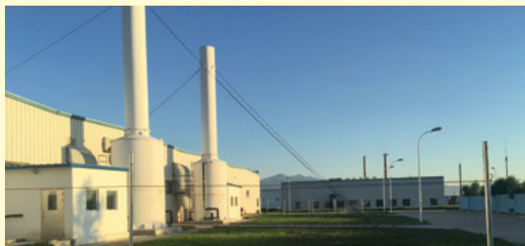
斯貝福(北京)生物技術有限公司環保設施 — 噴淋式洗滌塔 Environmental protection facilities in SPF (Beijing) Biotechnology Co., Ltd. — Spray tower
