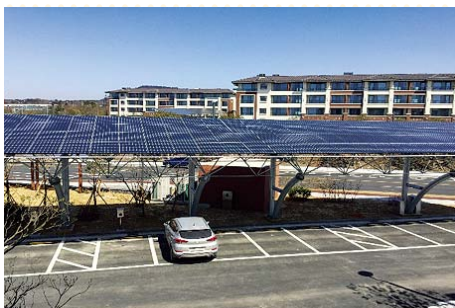
Solar panel carpark in Plot R R區之太陽能板停車場
