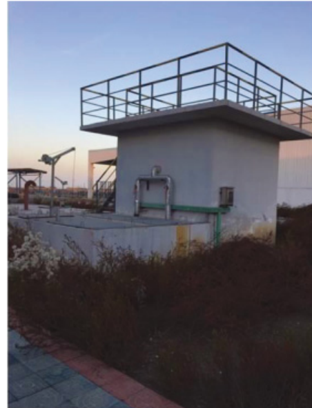
污水站—污泥槽
