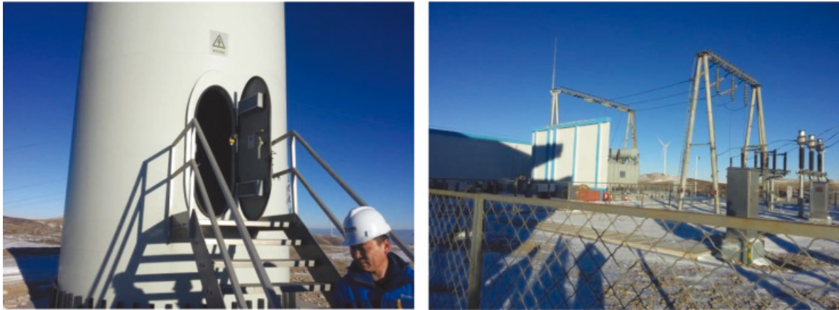
圖7.3廠區廠房設備示例 (典型風塔結構及能源開關係統)
