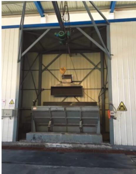
預處理進料口
