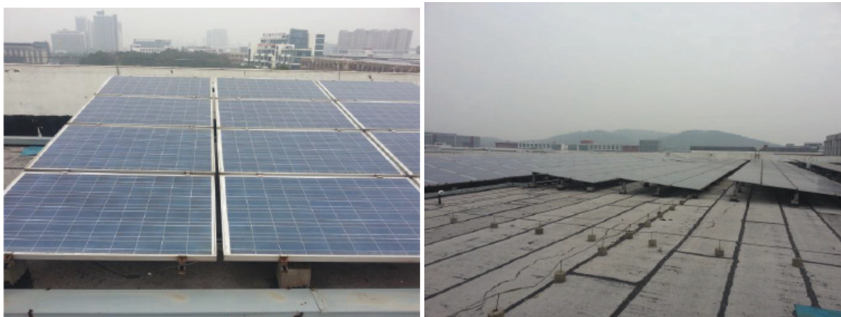
圖6.4 光伏組件陣列
