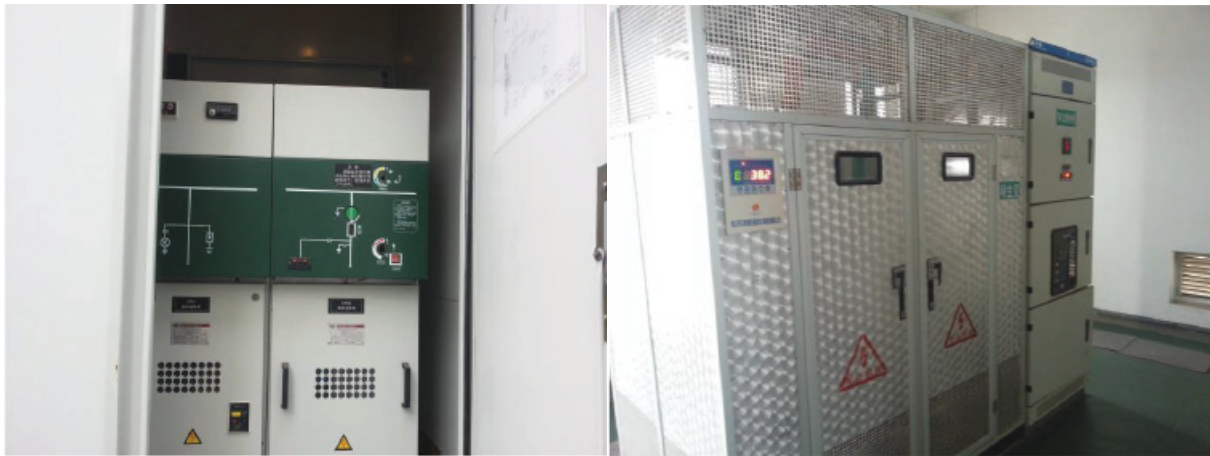
圖6.3廠區廠房設備示例 (典型光伏陣列支架系統及換流器系統)
