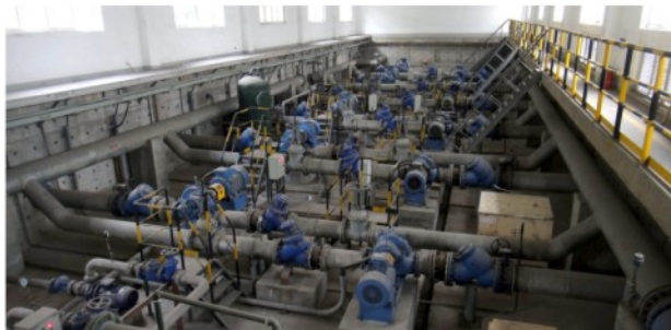
造循環泵房(工業冷卻)
