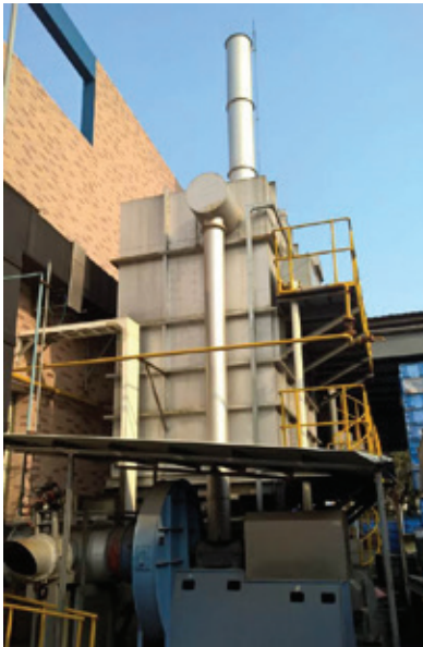
RTO廢氣處理設施
