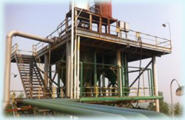
洛宁紫金废水处理系统
