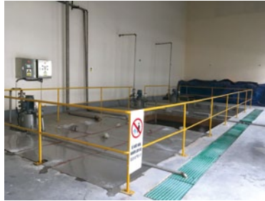
Texhong Dyeing Water Recycling Project 天虹染整中水回收項目
