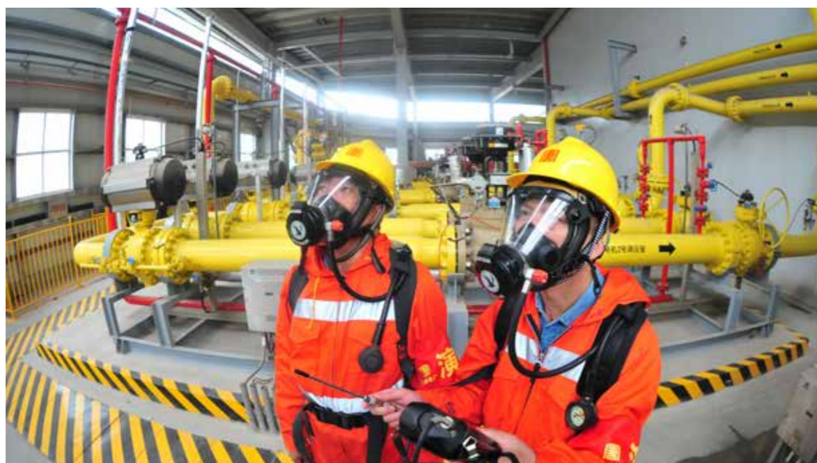
北京高井热电厂开展燃机调压站突发事故应急演练
