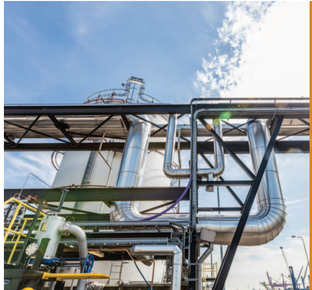
AVR 位於鹿特丹的發電廠增加工業客戶的蒸汽供應。
