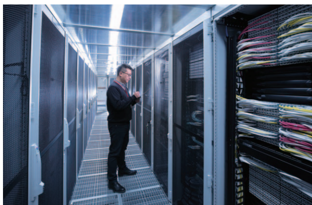
港燈兩個新數據中心落成，配備效能強大、安全和具能源效益的系統。
