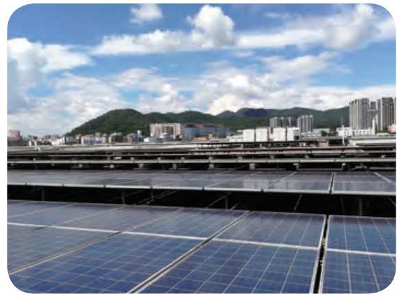
深圳機場太陽能項目
