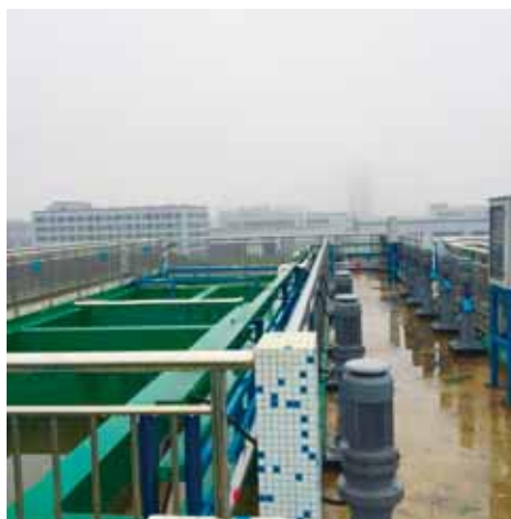
圖中是位於中國寧波其中一個廠區的污水處理設施
