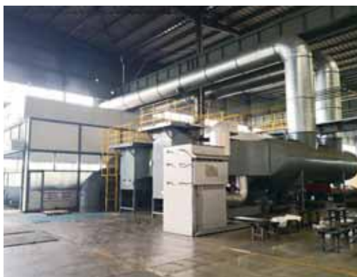
位於中國寧波其中一個廠區的廢氣處理設施
