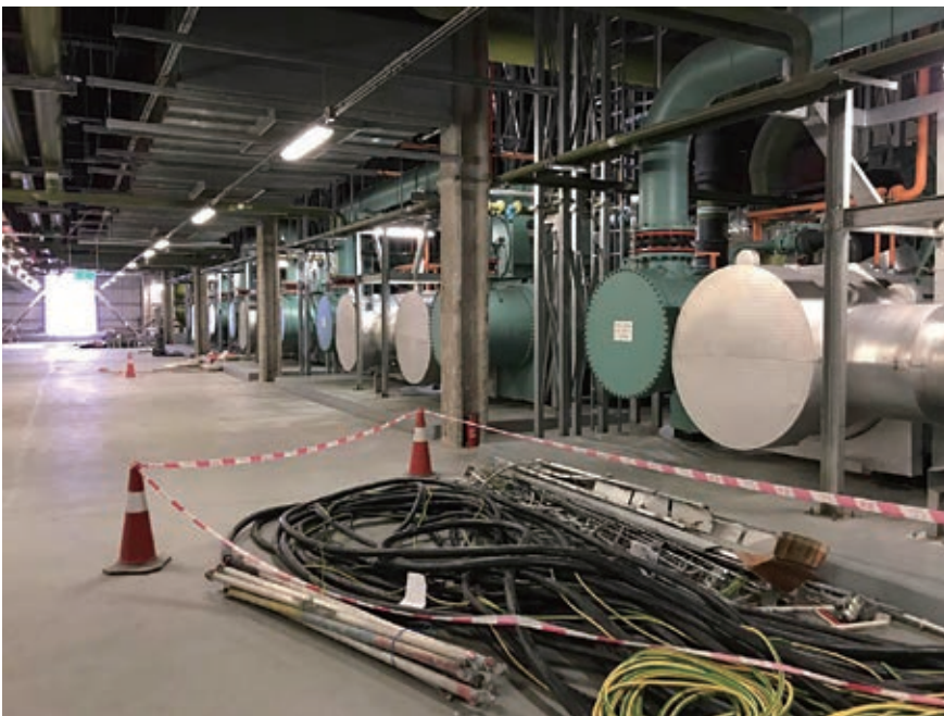
為酒店綜合大樓的電力中心 提供營運及維修服務
