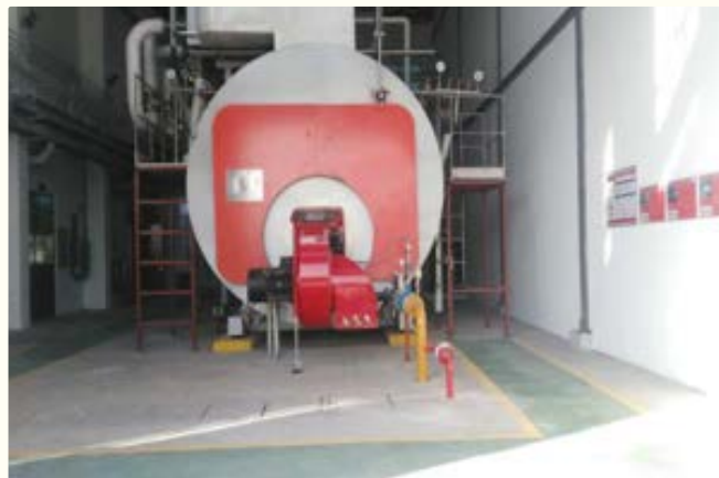
新增的燃氣鍋爐
