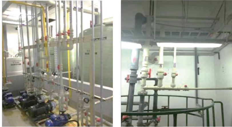
改造後的廢水處理間
