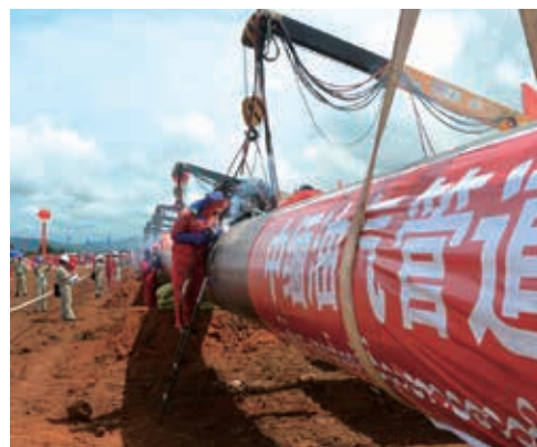
▲ 中緬油氣管道。
