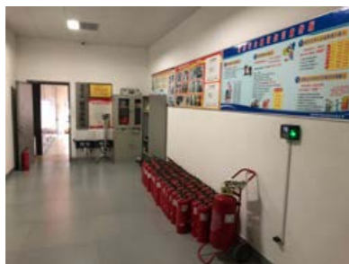
總部辦公大樓微型消防站
