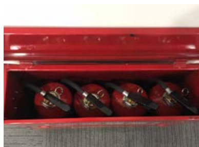
總部辦公大樓的滅火器
