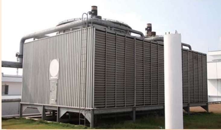
越南廠房 — 制冷設備
