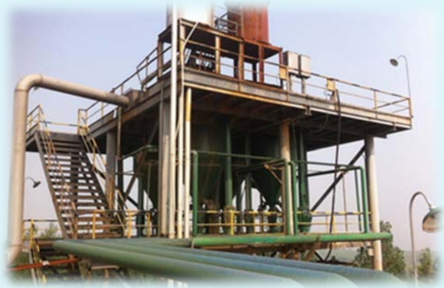
洛寧紫金廢水處理系統
