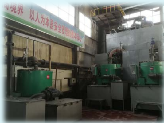
改造後的破碎工段除塵系統
