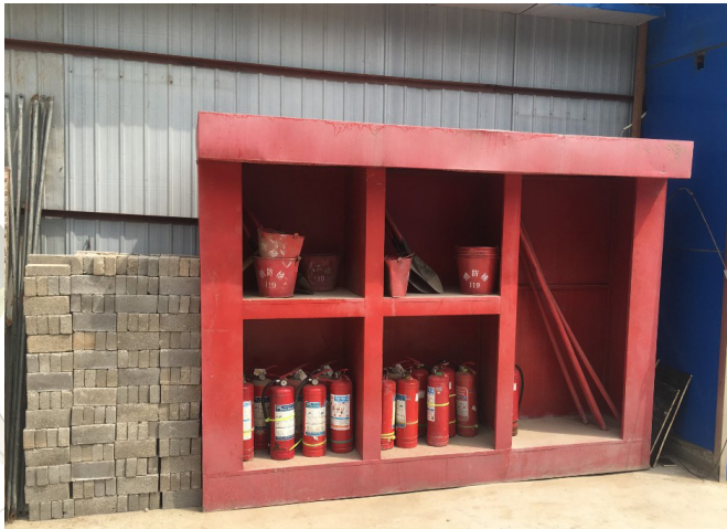
施工現場設置消防設備
