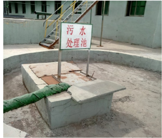
圖1. 工廠內部污水處理站
