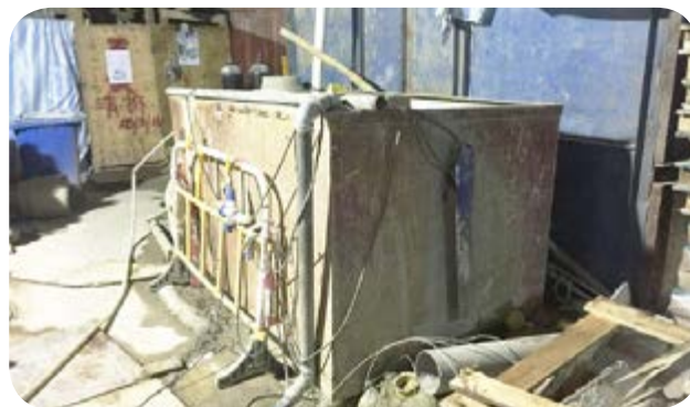
建築地盤的污水處理設施
