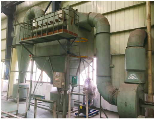
生產廠房中設有脈衝式濾袋集塵機
