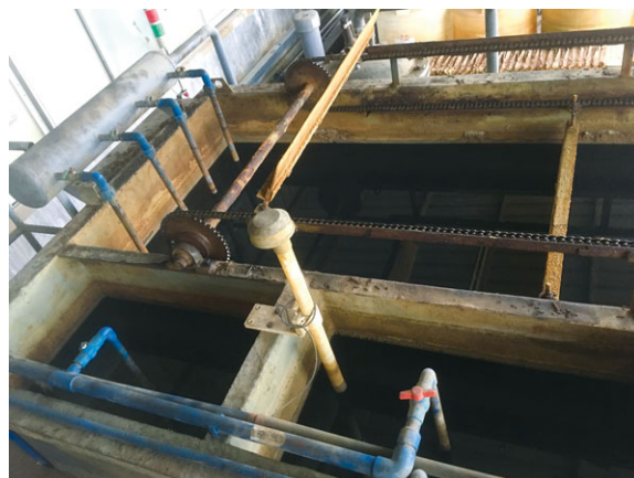
污水處理系統
