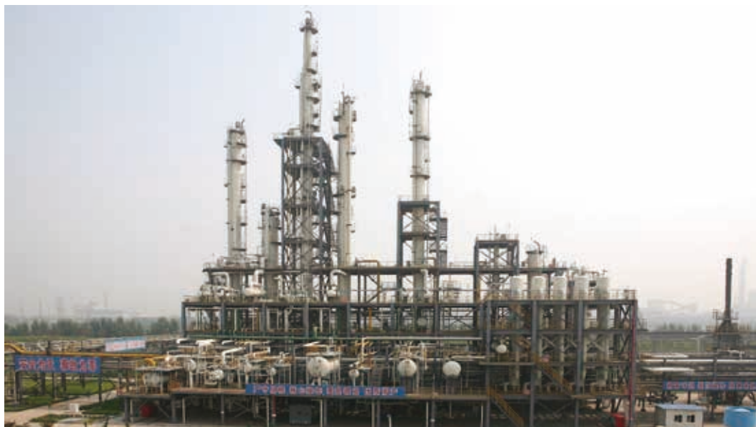
邢台生產基地的粗苯加氫精製設施
