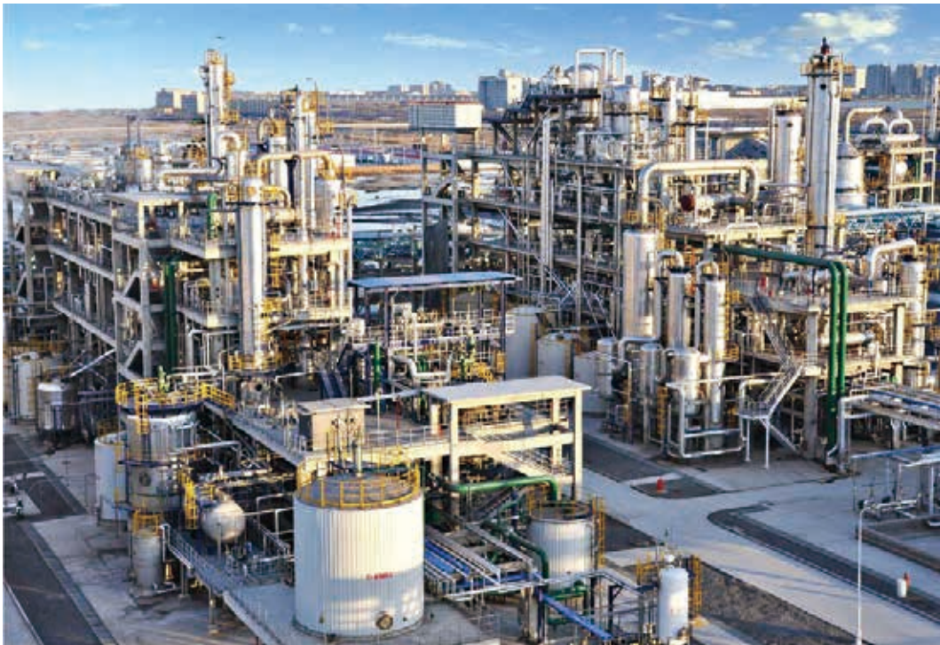
滄州生產園區的己內酰胺生產設施
