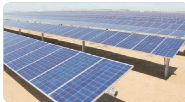
美國108mw太陽能發電
