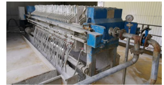
廢水廢漿壓濾機
