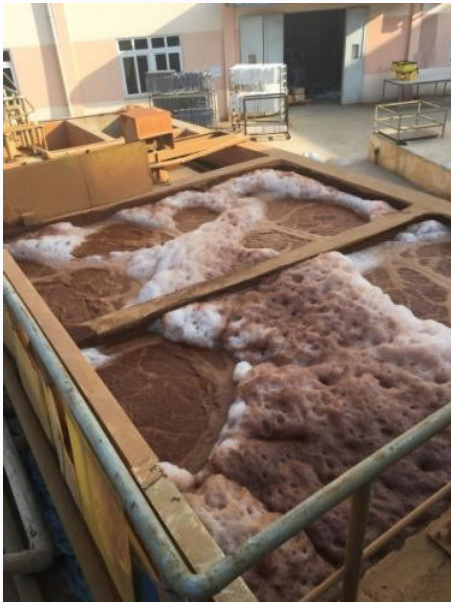
J.Y. Plasteel 透過微生物處理生活污水
