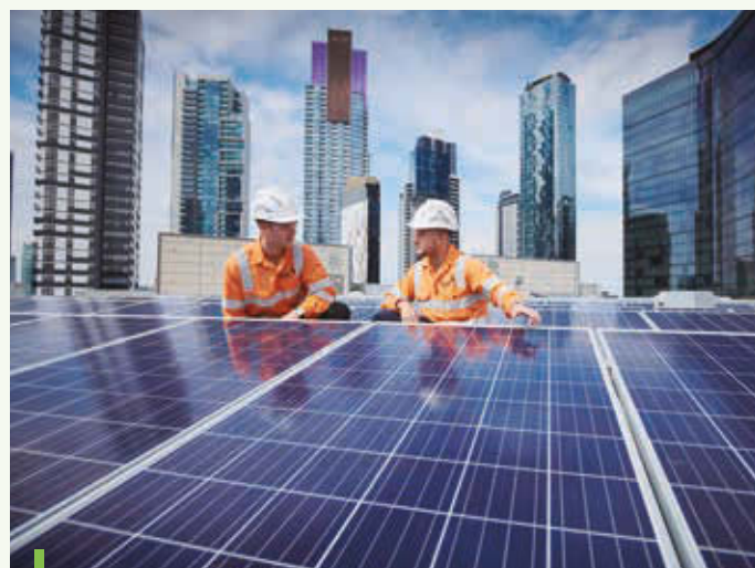
VPN 旗下 Beon Energy Solutions 於 Crown Melbourne 安裝墨爾本最大型的屋頂太陽能系統，發電容量達三百千瓦。
