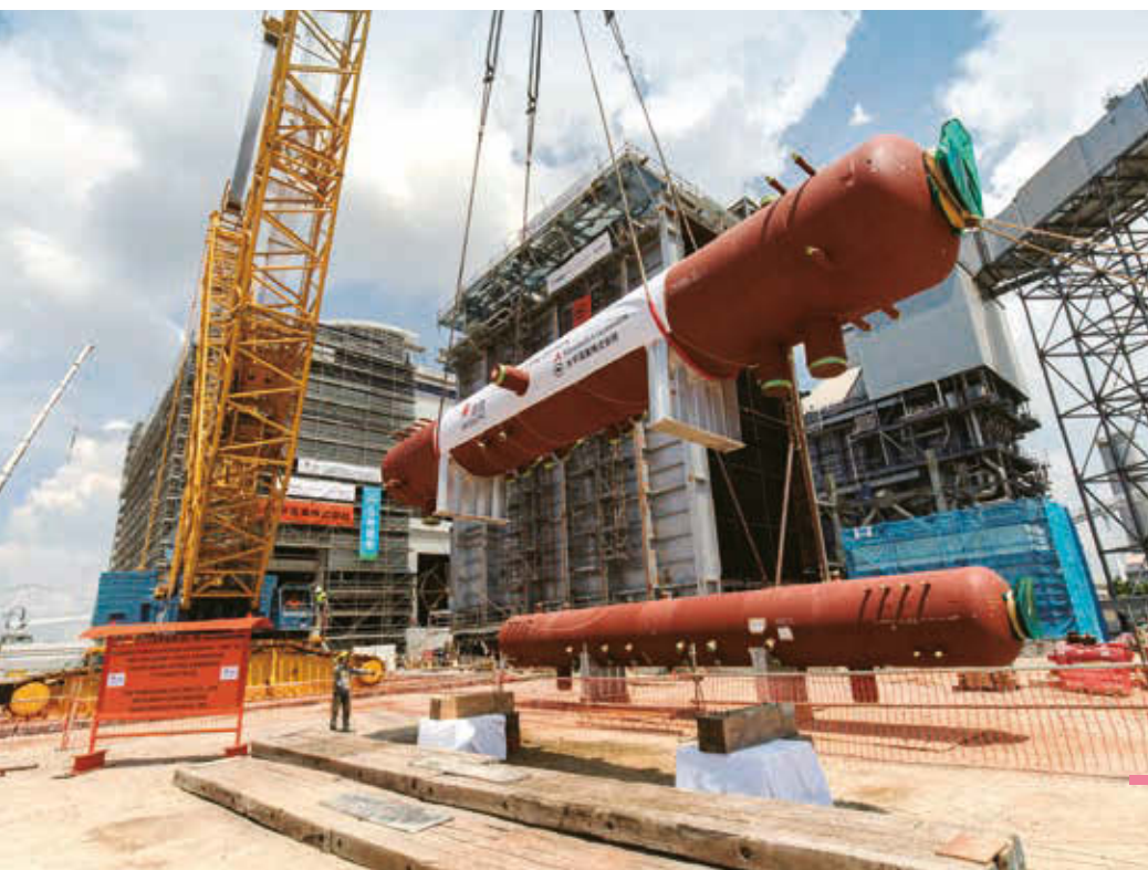
港燈的新聯合循環燃氣發電機組L10將於二零二零年投入運作。
