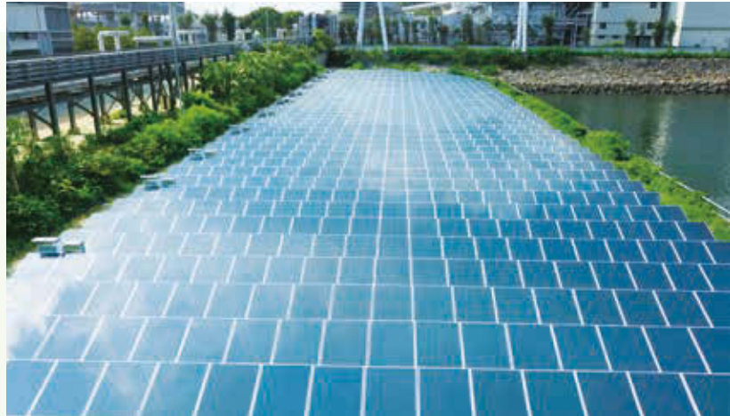
設於港燈南丫發電廠的太陽能發電系統。
