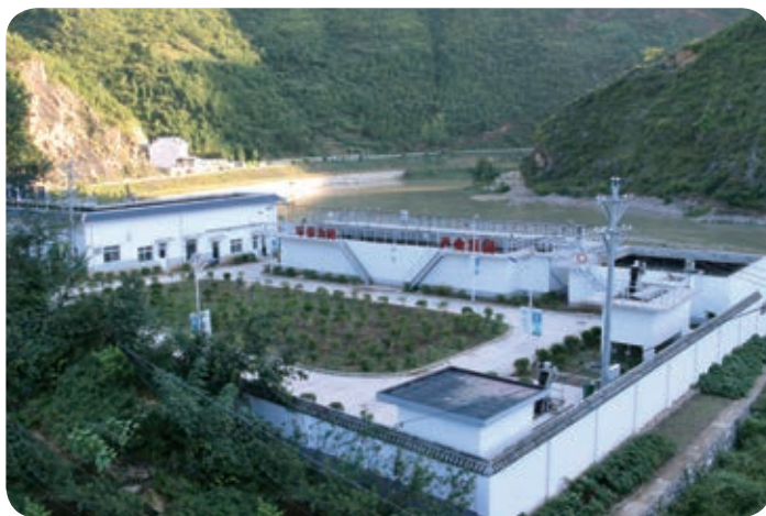
● 2018年，浙商銀行通過資本市場重點向新能源、生態環保、廢棄物處理等綠色行業提供約67億元融資支持，其中，浙商銀行西安分行有效支持陝西環保集團重點環保項目建設，圖為該集團下屬公司承建的污水處理廠
