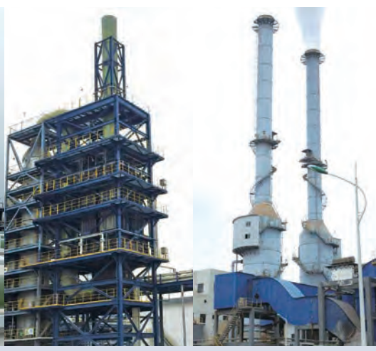
DMTO裝置廢氣除塵 設施
