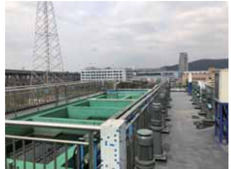
圖中是位於寧波其中一個廠區的污水處理設施
