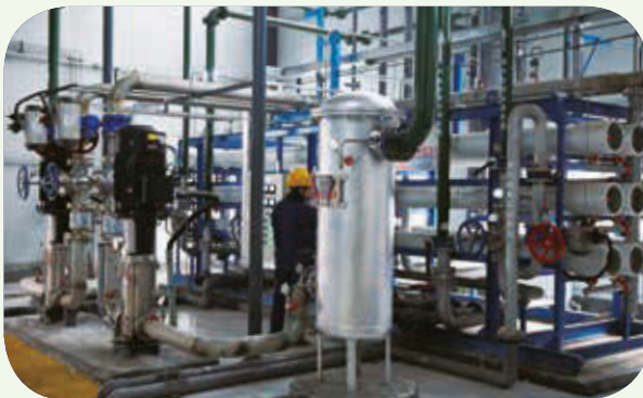
反滲透濃水處理裝置
