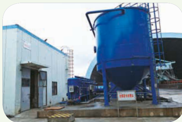
含煤廢水處理設施
