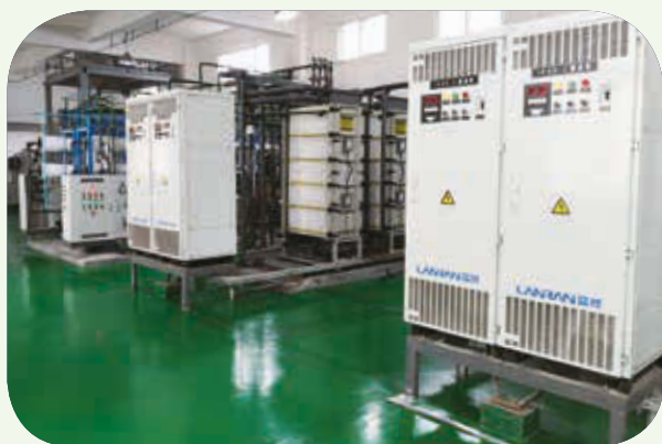
脫硫廢水處理設施
