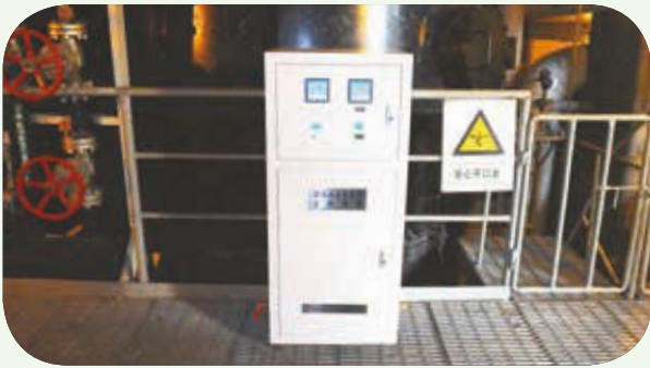
循環水生化處理監控裝置
