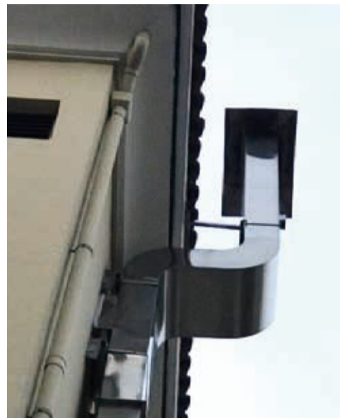
圖：揮發性有機物通風煙囪
