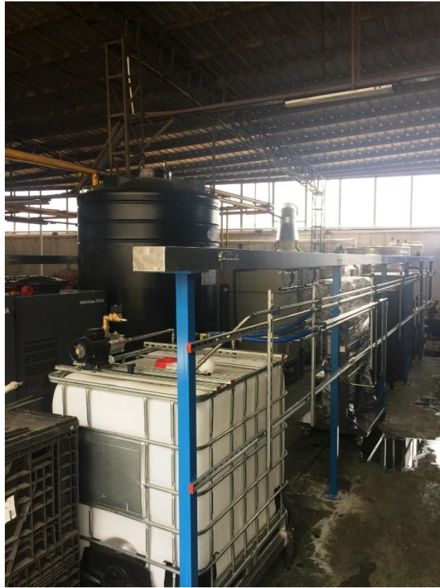
廢水處理系統
