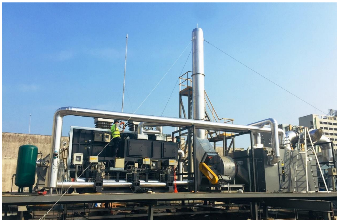
升級 VOC 設備
